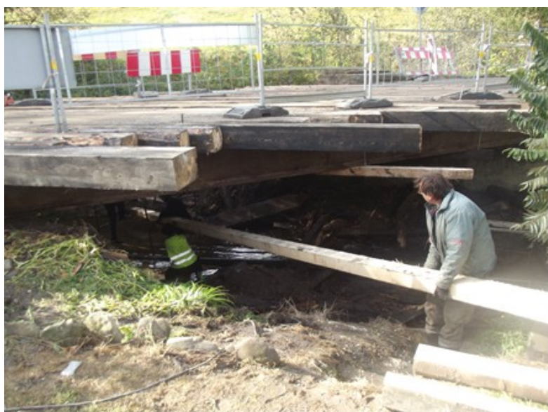
Fot. „Remont obiektu mostowego w ciągu drogi powiatowej nr 1678K Raba Wyżna – Podwilk w km 9+135 w miejscowości Podsarnie” – w trakcie realizacji
