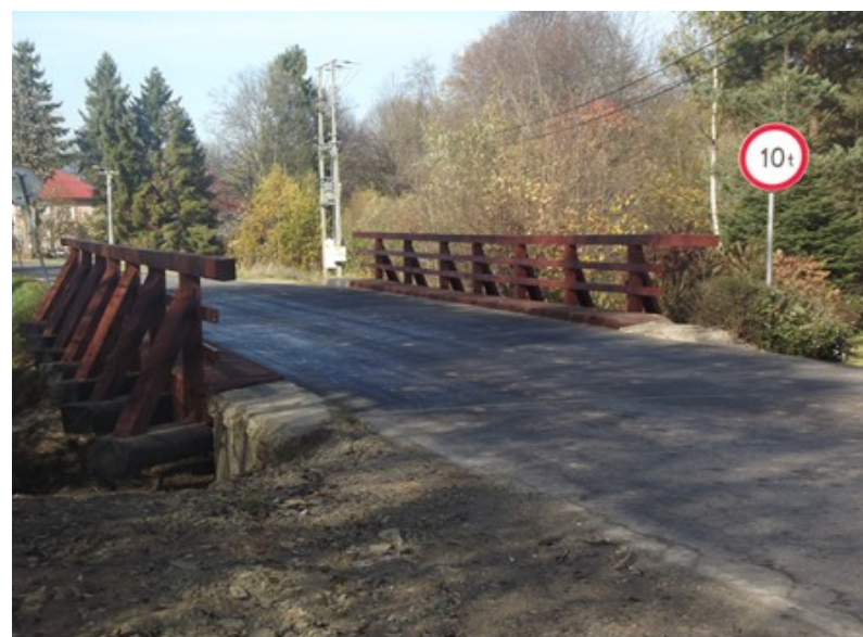
Fot. „Remont obiektu mostowego w ciągu drogi powiatowej nr 1678K Raba Wyżna – Podwilk w km 9+135 w miejscowości Podsarnie” – po wykonaniu remontu
