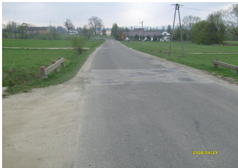
fot. droga K1668 Rabka – Skawa - Naprawa przed przebudową
