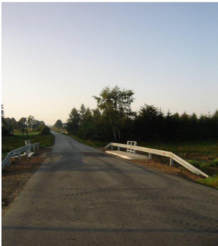
fot. Remont mostu na potoku bez nazwy w km 7+850 w c/d powiatowej nr K1669 Jordanów-Spytkowice
