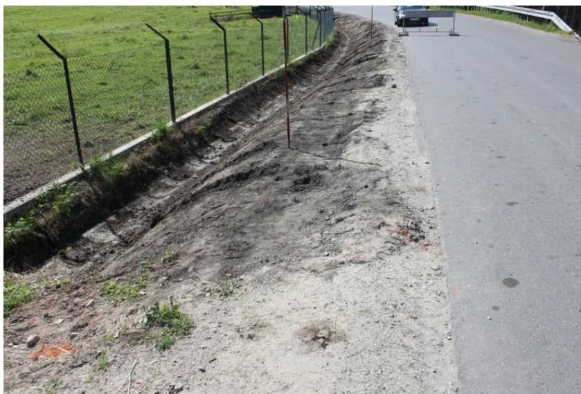
fot. droga K1668 Rabka – Skawa - Naprawa przed przebudową
