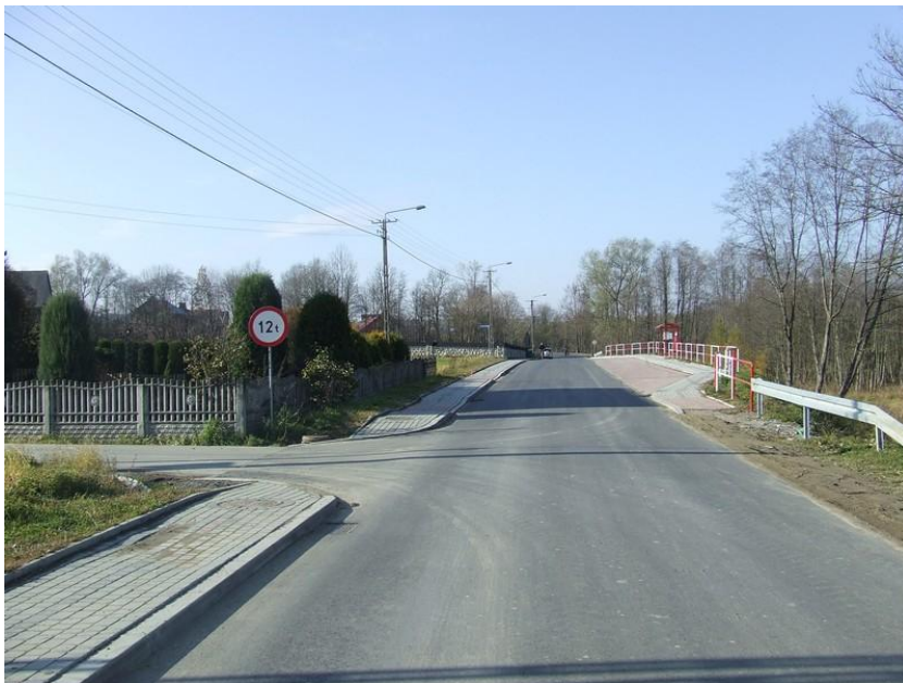
fot. Odbudowa drogi powiatowej nr K1678 Raba Wyżna -Podwilk od km 6+600 do km 8+500 oraz od km 10+100 do km 13+355” ”
