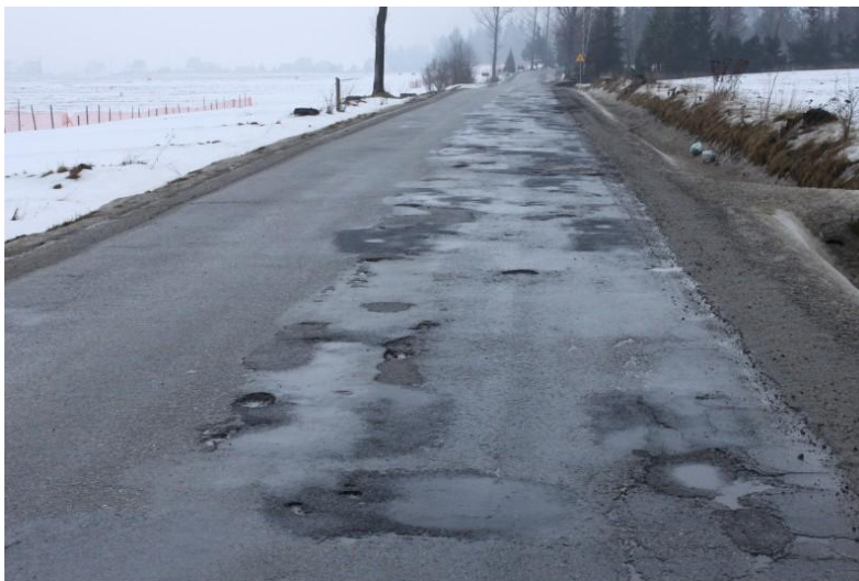
fot. droga K1660 Ludźmierz – Pyzówka przed przebudową
