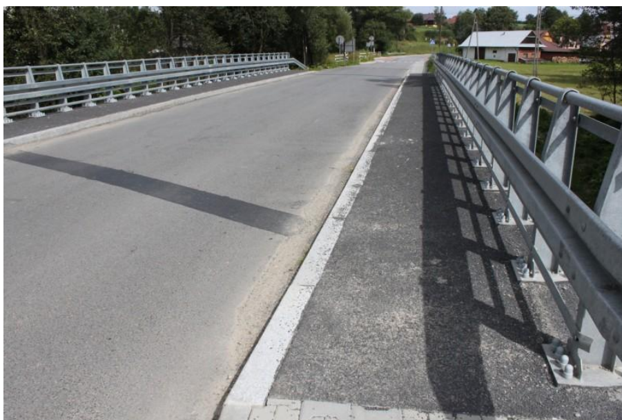
fot. obiekt mostowy po przebudowie K1668 Rabka – Skawa – Naprawa w km 5+582 na rzece Skawa
