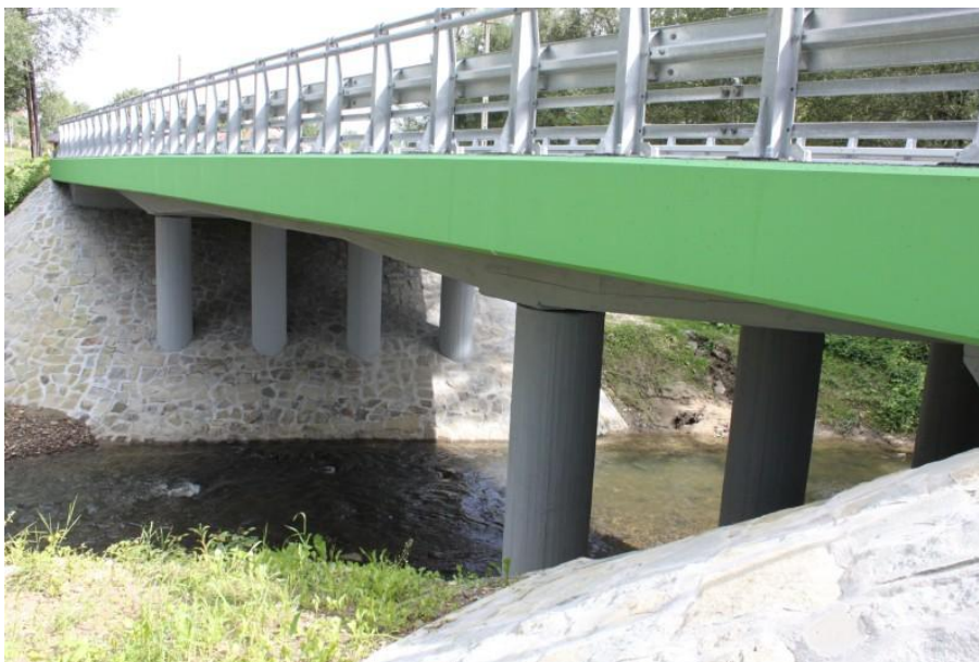
fot. obiekt mostowy po przebudowie K1668 Rabka – Skawa – Naprawa w km 5+582 na rzece Skawa
