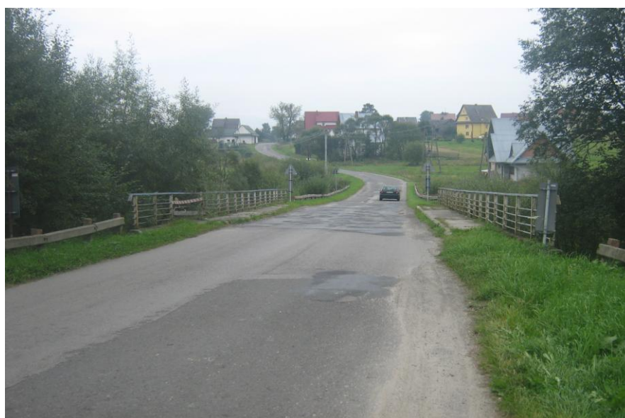
fot. obiekt mostowy przed przebudową K1668 Rabka – Skawa – Naprawa w km 7+670 na rzece Skawa
