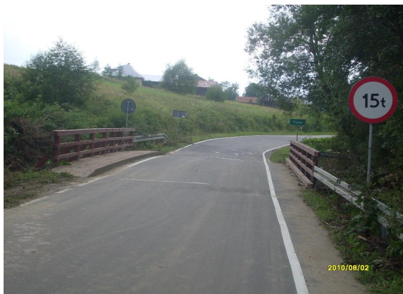
fot. obiekt mostowy przed przebudową K1642 Groń – Trybsz – Niedzica w km 5+050 na Trybskiej Rzece
