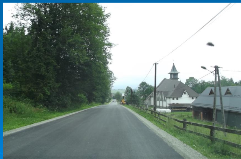
Fot. „Odbudowa nawierzchni drogi powiatowej nr K1646 Skrzypne – Szaflary - Ostrowsko od km 0+380 do km 4+180” – po przebudowie
