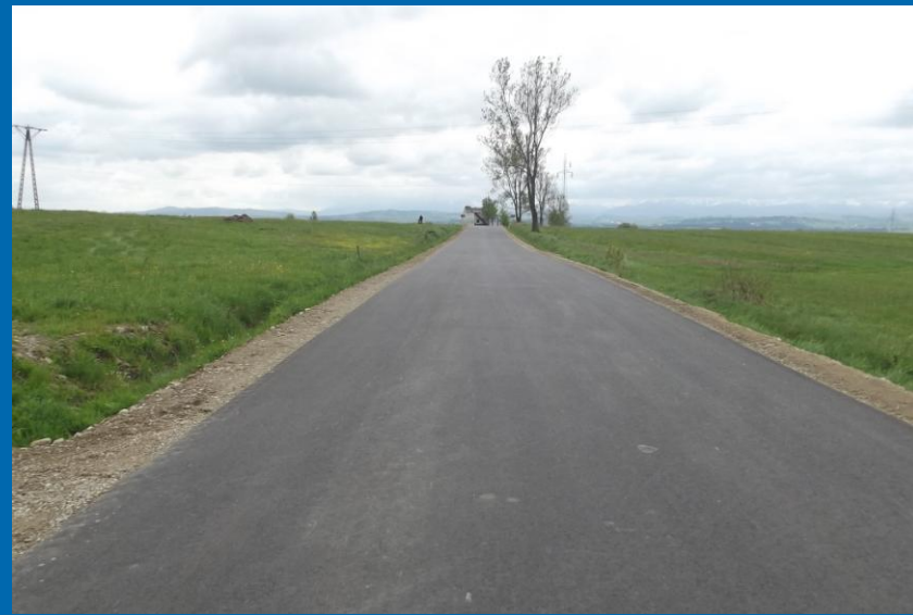
Fot. Odbudowa nawierzchni drogi powiatowej nr K1660 Ludźmierz – Pyzówka od km 2+930 do km 5+240 – po odbudowie
