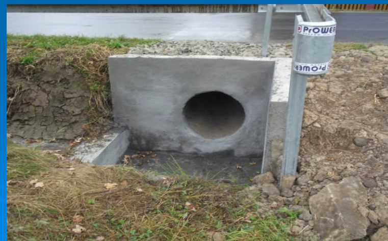
Fot. Czyszczenie i odmulanie studni przy przepustach i czyszczenie i odmulanie rur przepustów
