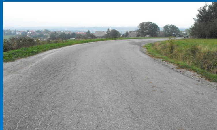
Fot. „Odbudowa nawierzchni drogi powiatowej nr K1653 Szaflary – Ząb od km 0+000 do km 7+227” – przed przebudową
