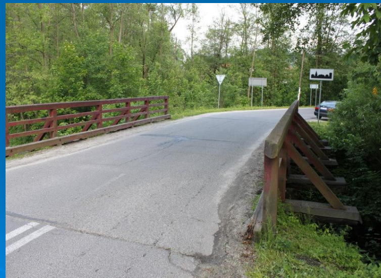
Fot. „Przebudowa mostu w km 0+025,60 w ciągu drogi powiatowej 1662K Raba Wyżna - Klikuszowa” – przed przebudową
