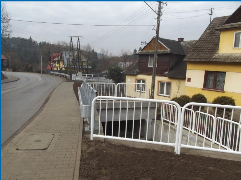
Fot. po przebudowie - regulacja biegu potoku Jędras przebiegającego pod tarczą skrzyżowania poprzez budowę przepustu żelbetowego
