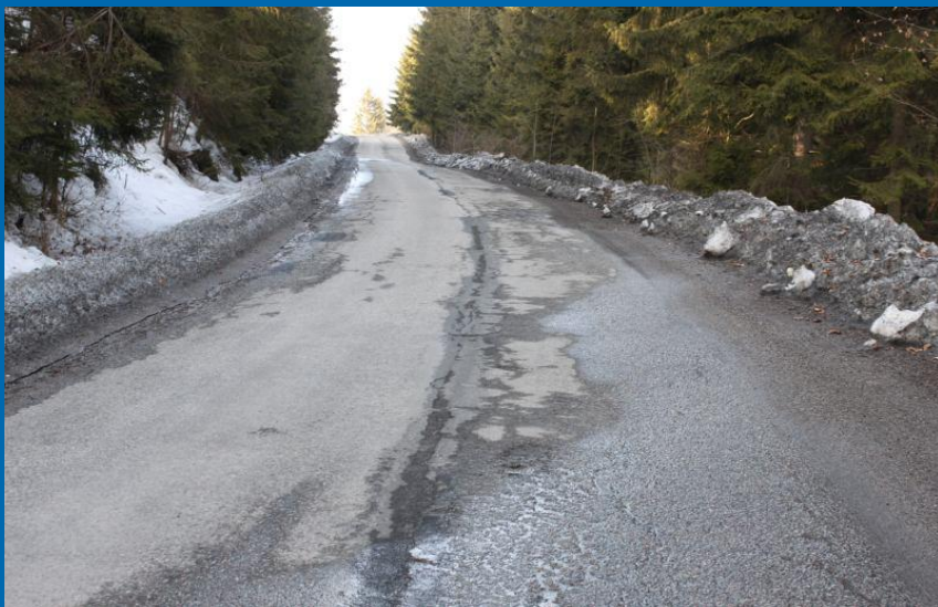
Fot. „Odbudowa nawierzchni drogi powiatowej nr K1664 Harkabuz - Piekienik od km 5+917 do km 9+040” – przed przebudową
