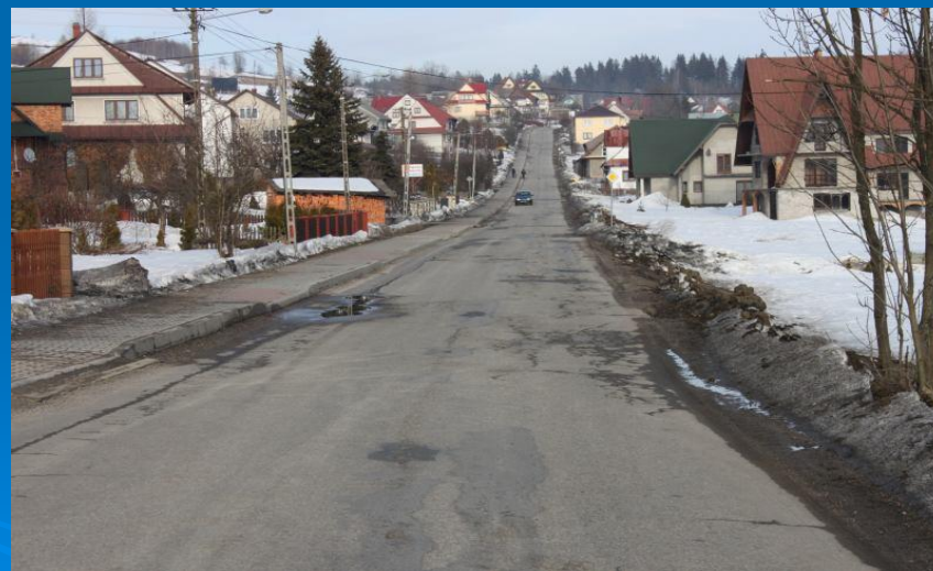
Fot. „Odbudowa nawierzchni drogi powiatowej nr K1664 Harkabuz - Piekielnik od km 5+917 do km 9+040” – przed przebudową
