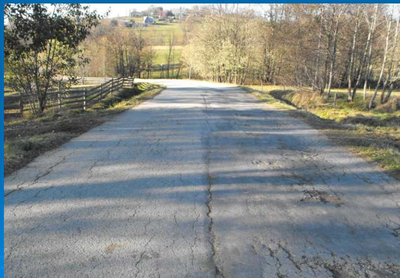
Fot. „Odbudowa nawierzchni drogi powiatowej nr K1652 Ciche – Dzianisz od km 5+000 do km 6+292” – przed przebudową
