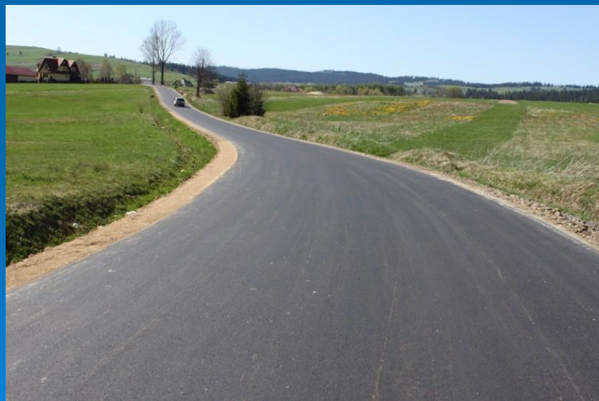
Fot. Odbudowa nawierzchni drogi powiatowej nr K1660 Ludźmierz – Pyzówka od km 2+930 do km 5+240 – po odbudowie
