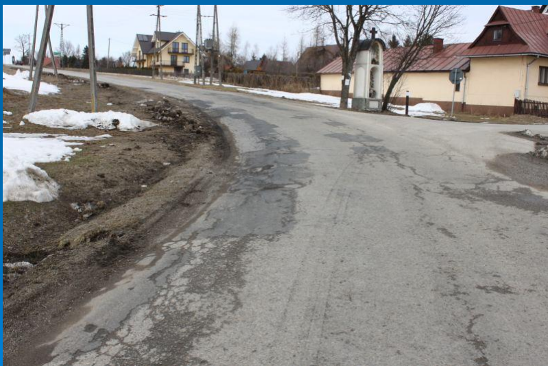
Fot. „Odbudowa nawierzchni drogi powiatowej nr K1655 Rogoźnik - Ciche od km 0+000 do km 3+940” - przed przebudową
