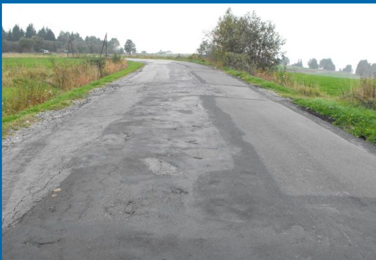
Fot. „Odbudowa nawierzchni drogi powiatowej nr K1653 Szaflary – Ząb od km 0+000 do km 7+227” – przed przebudową
