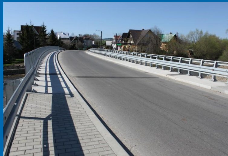
Fot. „Przebudowa mostu na potoku Lepietnica w ciągu drogi powiatowej 1660K Ludźmierz – Pyzówka” – po przebudowie
