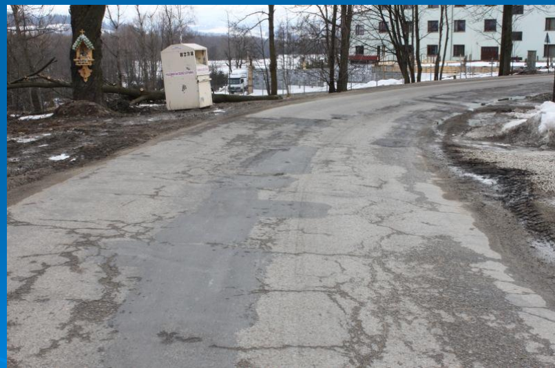
Fot. „Odbudowa nawierzchni drogi powiatowej nr K1655 Rogoźnik - Ciche od km 0+000 do km 3+940” - przed przebudową
