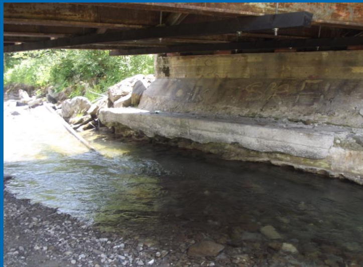
Fot. zniszczony przyczółek na obiekcie mostowym w ciągu drogi powiatowej nr 1661K Trute – Klikuszowa – Obidowa w km 6+763
