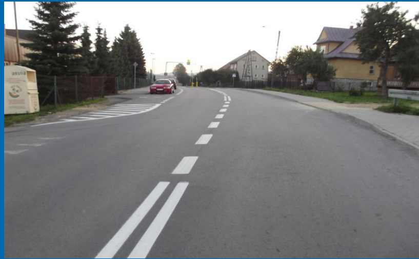
Fot. Oznakowanie poziome dróg
