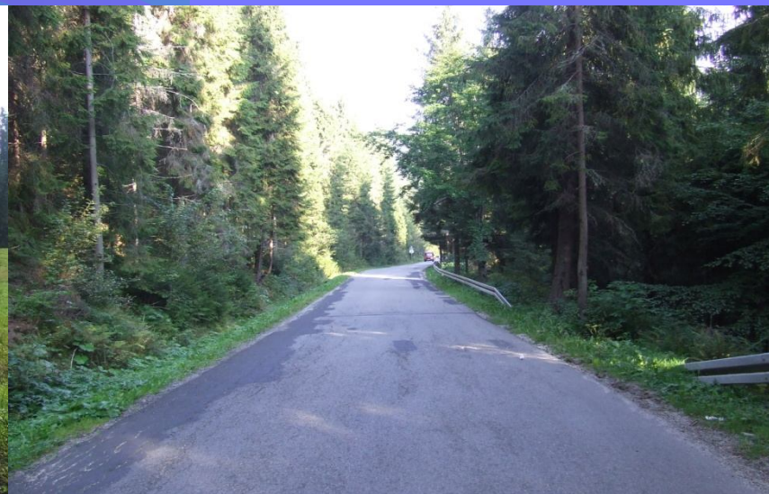
Fot. odcinek drogi powiatowej nr 1637K Harkłowa – Tylmanowa od km 6+000 do km 8+500 – przed remontem
