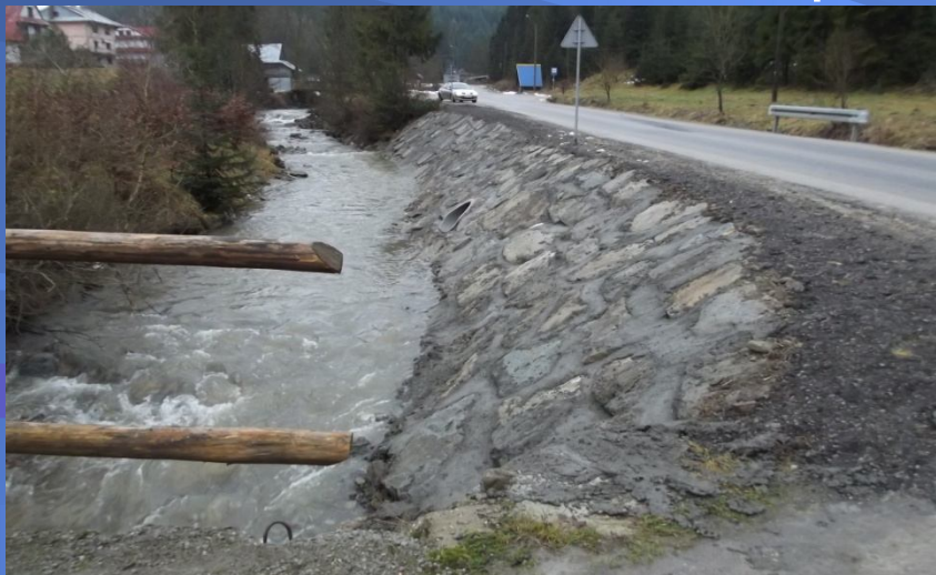
Fot. odcinek korpusu drogi powiatowej nr 1661K Trute – Klikuszowa – Obidowa – po odbudowie
