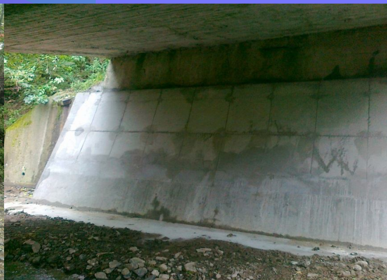
Fot. Remont obiektu mostowego na potoku Łapszanka w ciągu drogi powiatowej 1641K Łapsze Wyżne – Jurgów w km 0+179 – po remoncie
