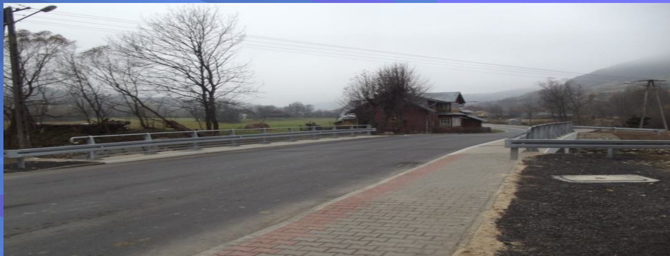
Fot. obiekt mostowy na pot. Luboński w ciągu drogi powiatowej nr 1637K Harkłowa – Tylmanowa – po remoncie
