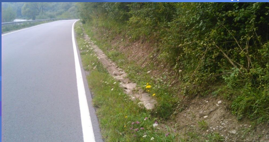
Fot. osuwisko Macelowa Góra w ciągu drogi powiatowej nr 1638K Krośnica – Sromowce Niżne – przed stabilizacją i zabezpieczeniem drogi
