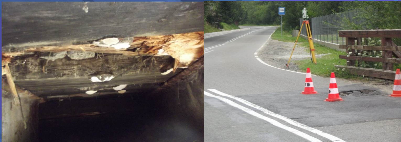
Fot. Remont pomostu drewnianego na potoku Skrodne w ciągu drogi powiatowej nr 1637K Harkłowa – Tylmanowa w km 15+887- przed remontem
