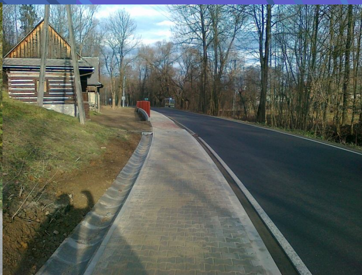
Fot. Remont pobocza i odwodnienia drogi powiatowej 1666K Ponice – Rdzawka w miejscowości Rdzawka – po przebudowie
