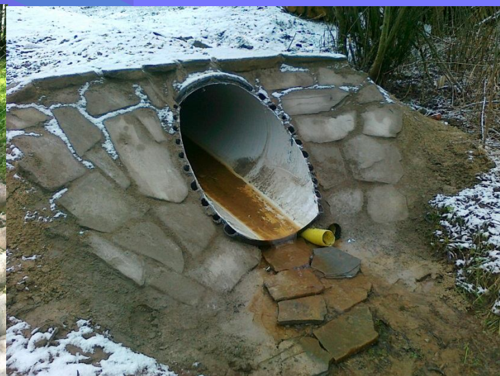
Fot. Obrukowanie wlotów i wylotów kamieniem na betonie z wypełnieniem spoin betonem
