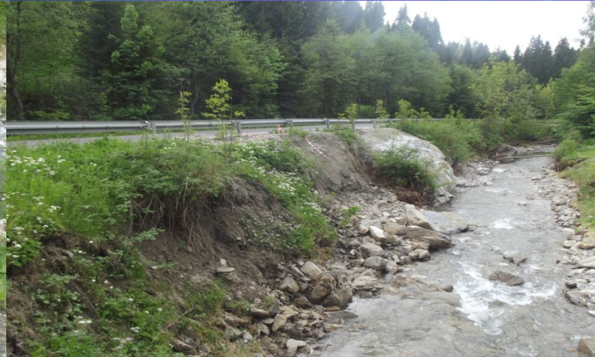
Fot. odcinek korpusu drogi powiatowej nr 1661K Trute – Klikuszowa – Obidowa – przed odbudową
