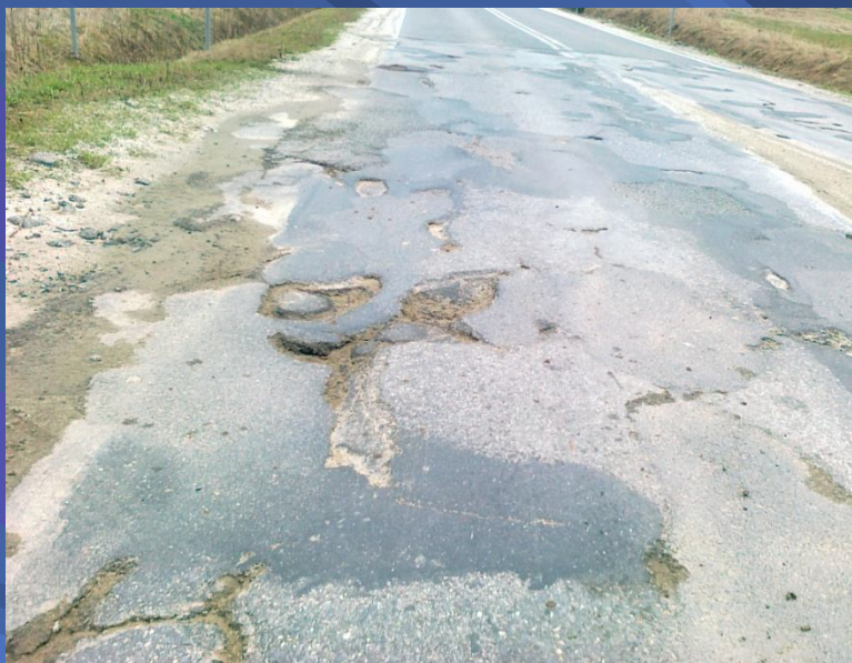
Fot. Remont nawierzchni mieszanką mineralno asfaltową w m. Dębno – przed robotami
