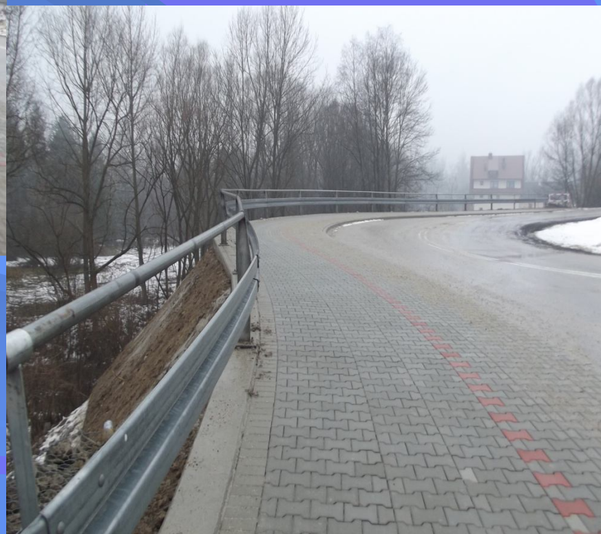
Fot. odcinek korpusu i chodnika w ciągu drogi powiatowej nr 1638K Krośnica – Sromowce Niżne – po odbudowie
