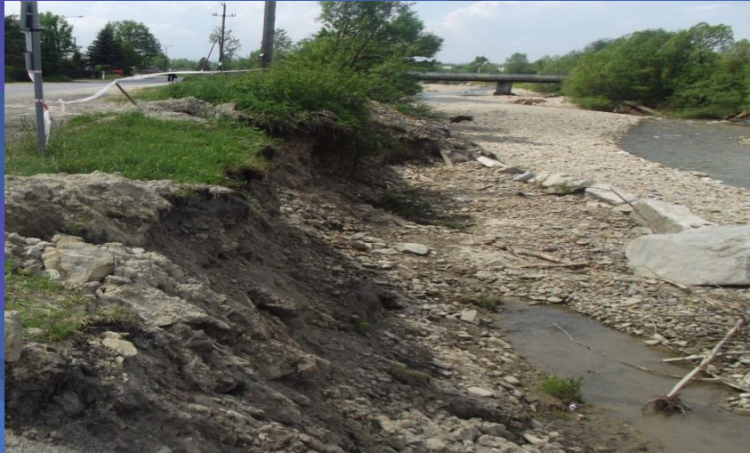
Fot. odcinek korpusu drogi powiatowej nr 1661K Trute – Klikuszowa – Obidowa – przed odbudową
