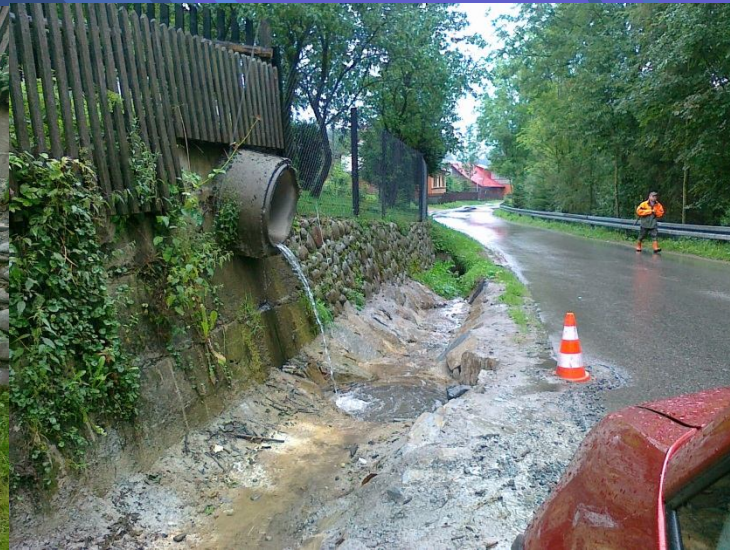
Fot. Oberwany i zniszczony korpus drogi wraz z odpływem
