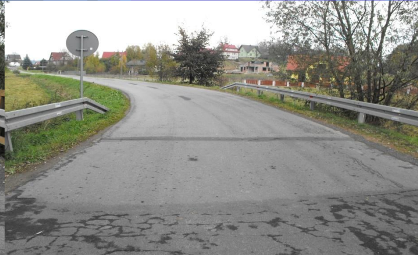
Fot. obiekt mostowy na potoku Skawa w ciągu drogi powiatowej nr 1669K Jordanów – Spytkowice – przed odbudową
