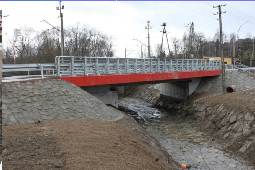
Fot. obiekt mostowy na potoku Stachorówka w ciągu drogi powiatowej nr 1668K Rabka Zdrój – Skawa – Naprawa – po odbudowie
