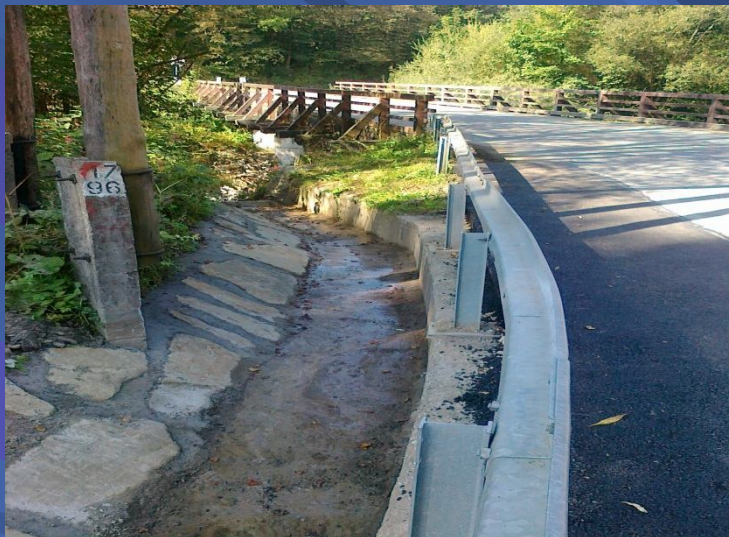
Fot. remont podmytego i uszkodzonego muru oporowego, pobocza drogi powiatowej 1636K Krościenko – Szczawnica
