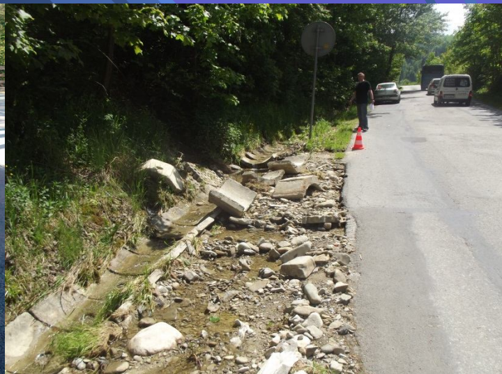
Fot. remont podmytego i uszkodzonego muru oporowego, pobocza drogi powiatowej 1636K Krościenko – Szczawnica – wystąpienie intensywnych opadów
