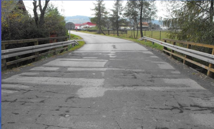
Fot. obiekt mostowy na potoku Skawa w ciągu drogi powiatowej nr 1669K Jordanów – Spytkowice – przed odbudową
