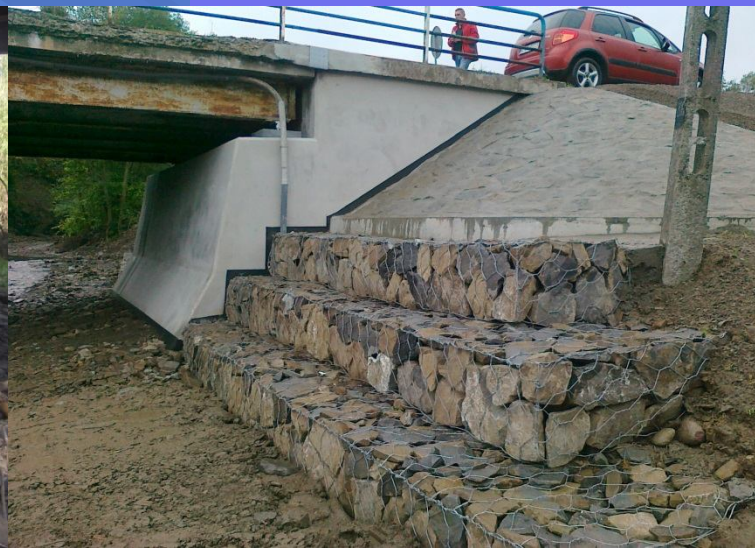
Fot. Remont obiektu mostowego na potoku Łapszanka w ciągu drogi powiatowej 1641K Łapsze Wyżne – Jurgów w km 0+732 – po remoncie
