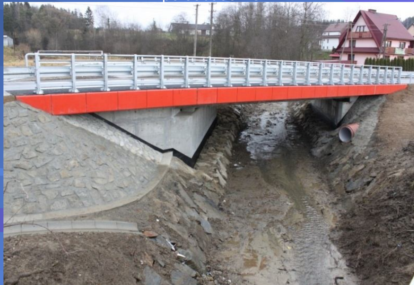
Fot. obiekt mostowy na potoku Stachorówka w ciągu drogi powiatowej nr 1668K Rabka Zdrój – Skawa – Naprawa – po odbudowie
