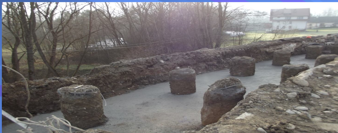
Fot. odcinek korpusu i chodnika w ciągu drogi powiatowej nr 1638K Krośnica – Sromowce Niżne – w trakcie realizacji
