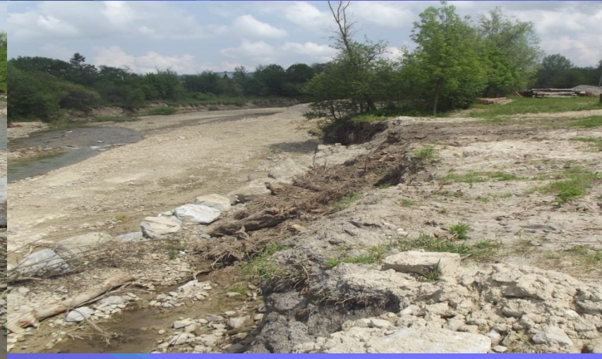
Fot. odcinek korpusu drogi powiatowej nr 1661K Trute – Klikuszowa – Obidowa – przed odbudową
