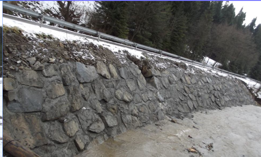
Fot. odcinek korpusu drogi powiatowej nr 1661K Trute – Klikuszowa – Obidowa – po odbudowie
