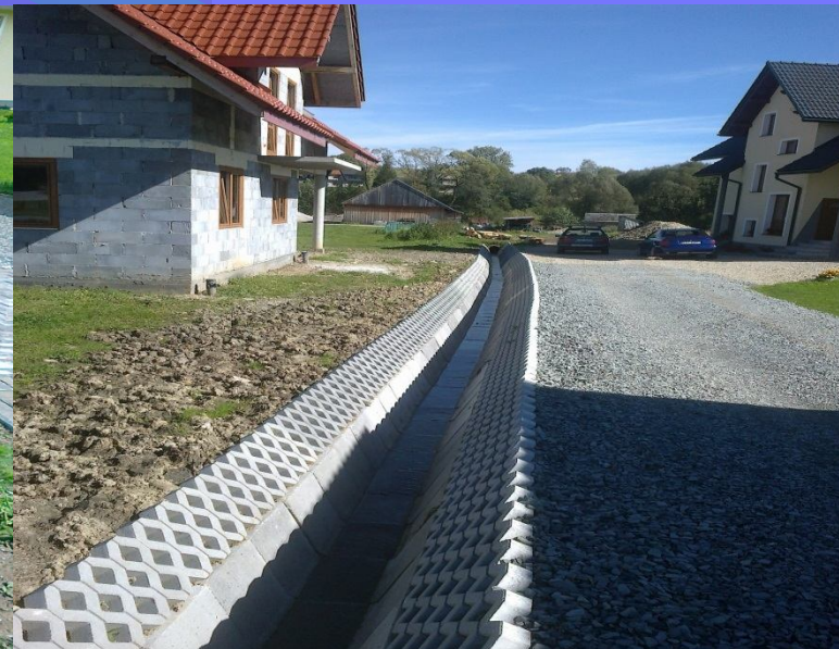
Fot. Odbudowa odpływu od przepustu drogowego – po wykonaniu prac – m. Lipnica Mała
