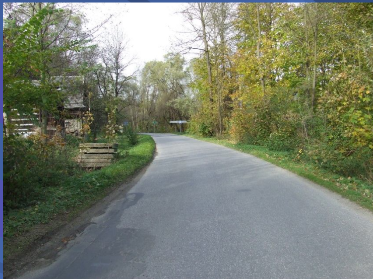
Fot. Remont pobocza i odwodnienia drogi powiatowej 1666K Ponice – Rdzawka w miejscowości Rdzawka – przed przebudową
