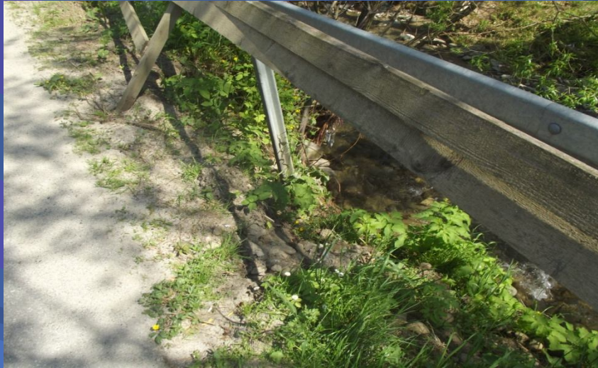
Fot. odcinek korpusu drogi powiatowej nr 1637K Harkłowa – Tylmanowa – przed odbudową
