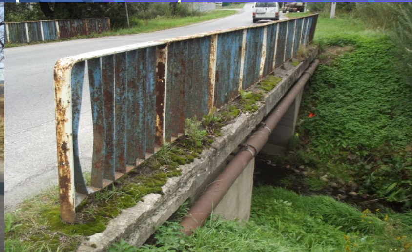
Fot. obiekt mostowy w ciągu drogi powiatowej nr 1673 ul. Waksmundzka w miejscowości Nowy Targ – przed remontem
