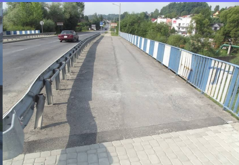
Fot. obiekt mostowy na potoku Skomielniczanka w ciągu drogi powiatowej nr 1668K Rabka – Skawa – Naprawa – przed modernizacją
