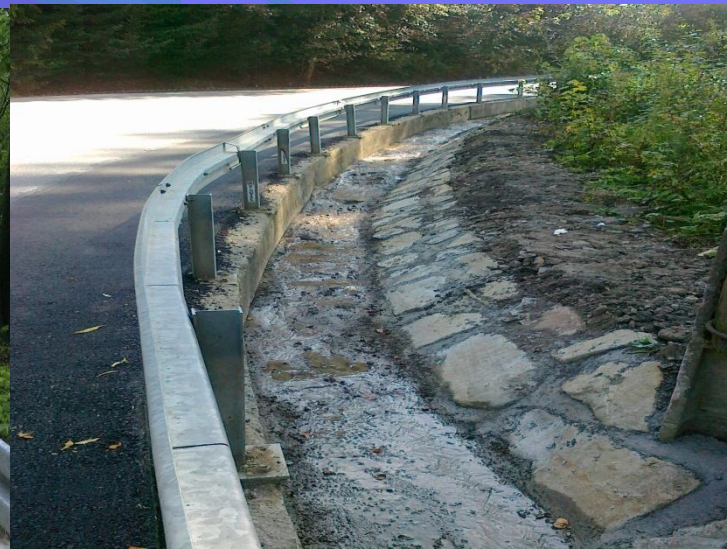
Fot. remont podmytego i uszkodzonego muru oporowego, pobocza drogi powiatowej 1636K Krościenko – Szczawnica
