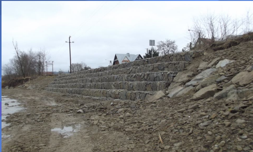
Fot. odcinek korpusu drogi powiatowej nr 1661K Trute – Klikuszowa – Obidowa – po odbudowie
