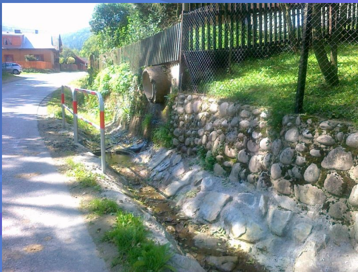
Fot. Oberwany i zniszczony korpus drogi wraz z odpływem
