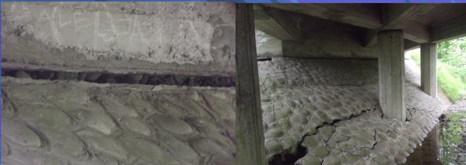
Fot. Zabezpieczenie fundamentu skrajnego przez obrukowanie skarpy na obiekcie mostowym w ciągu drogi powiatowej nr 1654K Ząb – Ratułów – Ciche – Chochołów w km 8+731 w miejscowości Czerwienne – przed remontem – widoczne zapadnięcie w rejonie podpory skrajnej
