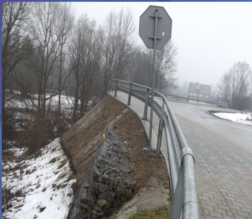
Fot. odcinek korpusu i chodnika w ciągu drogi powiatowej nr 1638K Krośnica – Sromowce Niżne – po odbudowie
