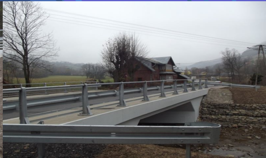
Fot. obiekt mostowy na pot. Luboński w ciągu drogi powiatowej nr 1637K Harkłowa – Tylmanowa – po remoncie
