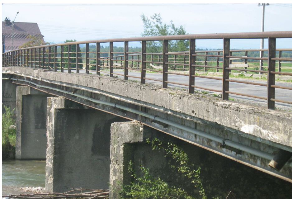
fot. Obiekt mostowy na potoku Czarny Dunajec w km 7+732 w/c drogi powiatowej nr K1659 Ludźmierz-Czarny Dunajec przed odbudową
